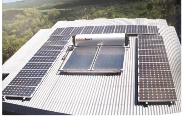
Şekil 32. Çatıda Güneş kolektörü ve fotovoltaik paneller, (M. Guzowski, 2019)
