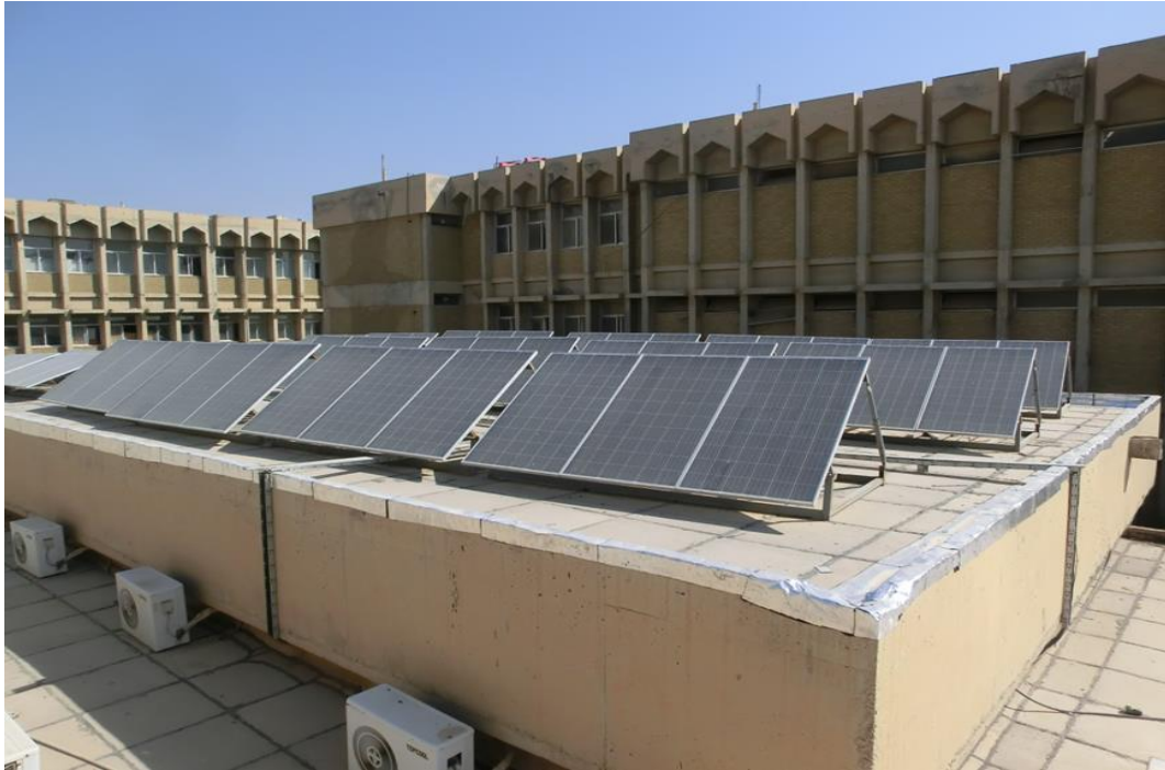
شكل رقم (٢) يوضح الخلايا الشمسية فوق بناية الهندسة الكهربائية
