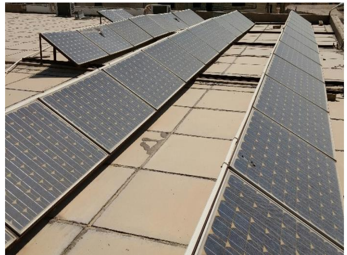
Fig. 2-a Stand Alone 3 KW PV system.
